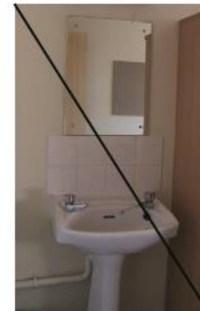
Плохо Раковина с пьедесталом. Фартук из плитки
